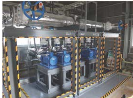
コントローラー一体型 P Mモータ搭載ポンプ (5 台制御) による圧送システム
